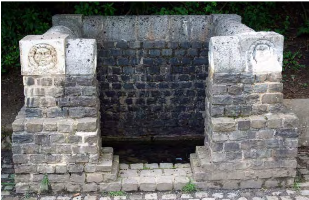
Quellfassung "Grüner Pütz" bei Nettersheim
